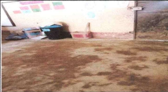
Foto 7: SE REQUIERE SUSTITUCION DE PISO
